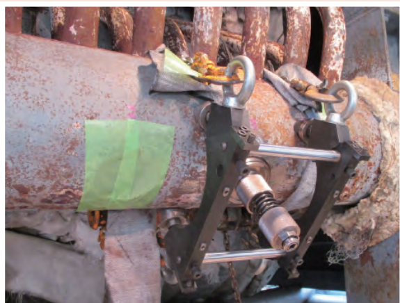
ハンドホール面圧座 補助ボイラー
